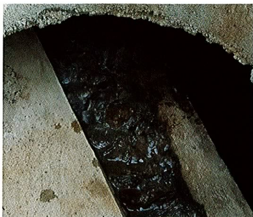
Déversoir d'orage colmaté par des lingettes – perte de pollution vers le milieu naturel
