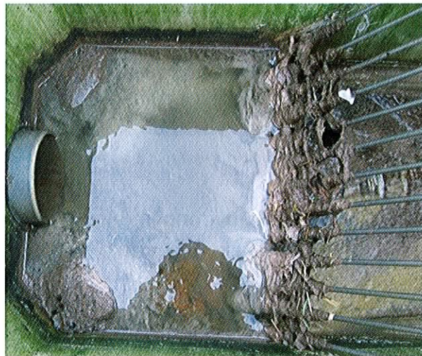
Dégrillage station d'épuration – capture des déchets non dégradables – lingettes, plastiques, ect
